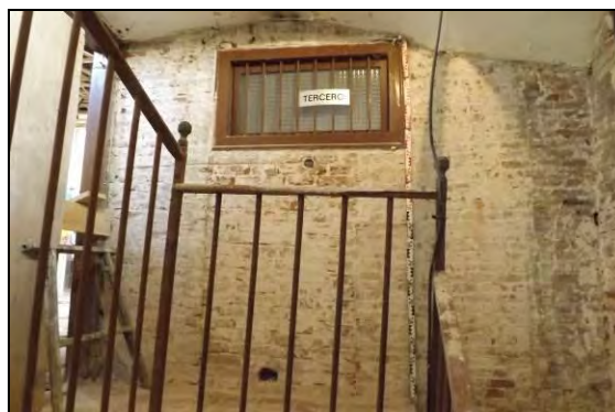
Vista en alçat del mur Oest que marca el replà de l'escala
