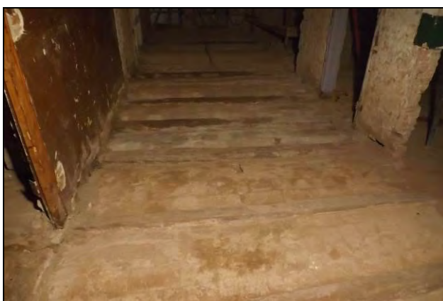
Vista general dels paviments dels Àmbits 5 i 7 i vòstè final del forjat
