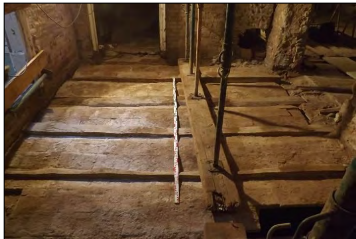
Vista del paviment i forjat de l' Àmbit 17 i detall del tir de la xemeneia
