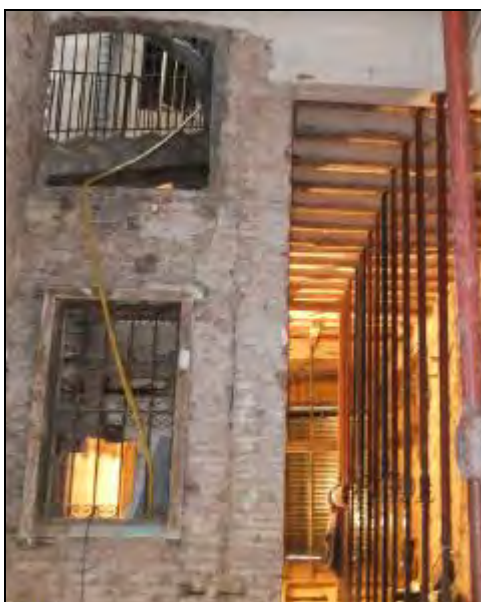
Fase III. Vista de part de la façana posterior (MR-B) on es veuen les traces de l'escala de cargol de ferro
